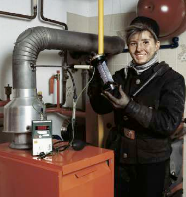
Da freut sich die Schornsteinfegerin: Brennwertheizungen glänzen mit niedrigen Abgaswerten.
