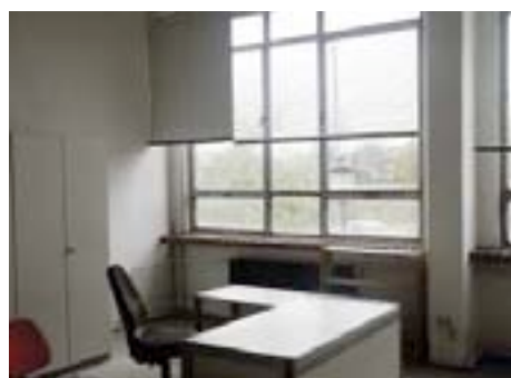
Undichte Fenster und beengte Räume kennzeichneten die Arbeitsbedingungen im alten Domizil.
