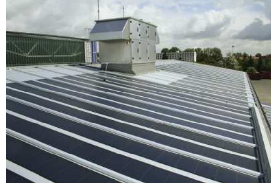
Solarkraftwerk auf dem Dach der Stadtwerke Weimar
